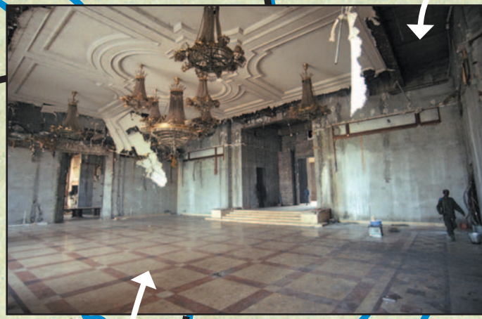
Gbadolite et Mbandaka : les palais en ruine de Mobutu
